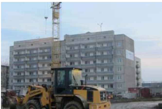
Жилой дом по ул. Сокольской на 216 квартир для «очередников», «переселенцов» из ветхого и аварийного жилья и другим категориям граждан
